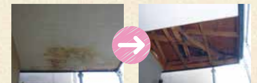
軒裏天井にシミが出ています。開けてみると水漏れ の跡が…。 水漏れの原因を調べてから修繕工事が必要です。
